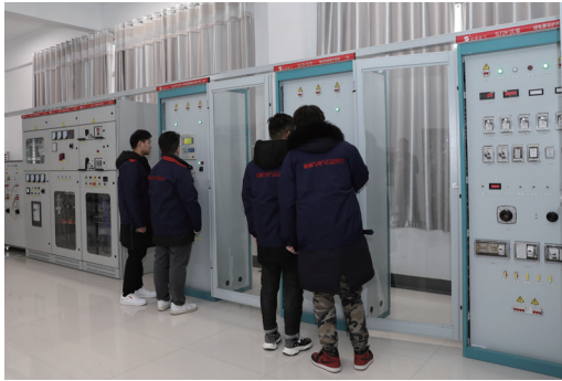
「電力系統綜合自動化實訓室」
